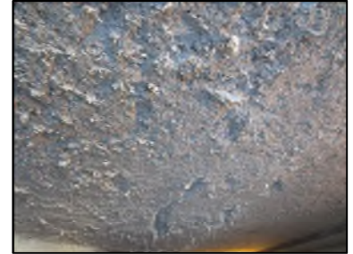
Photo N° 663 ECH-N°1 FLOCAGE -- LOCAL POUBELLE Plafonds blanc cotonneux
